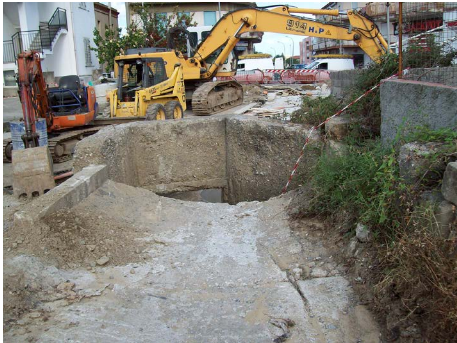
foto 14 - Criticità rappresentata dal salto dal canale a monte della SP. 147 verso il tombino di entrata del tratto tombinato sotto la Via Bruca.
