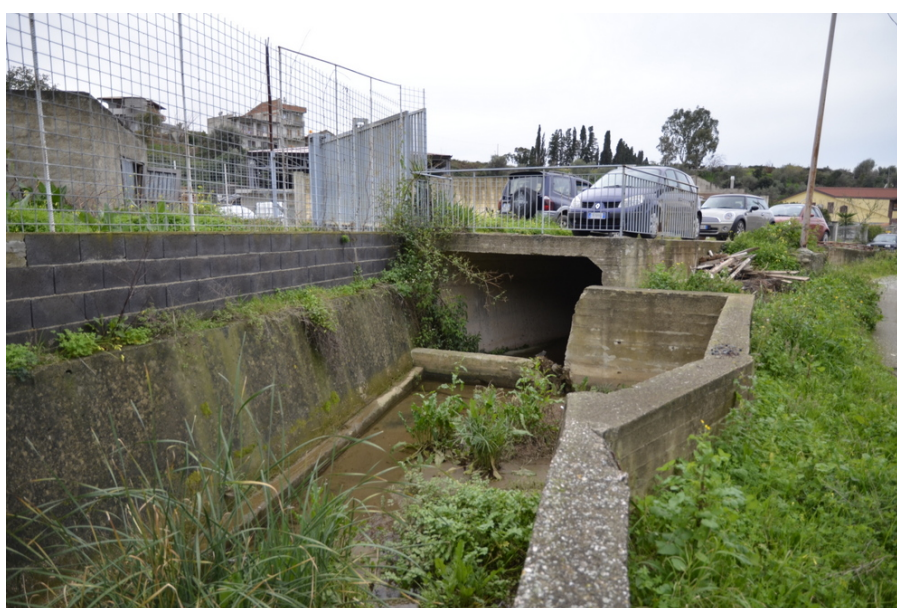
foto 2 - ingresso tratto tombinato vallone Piscittina
